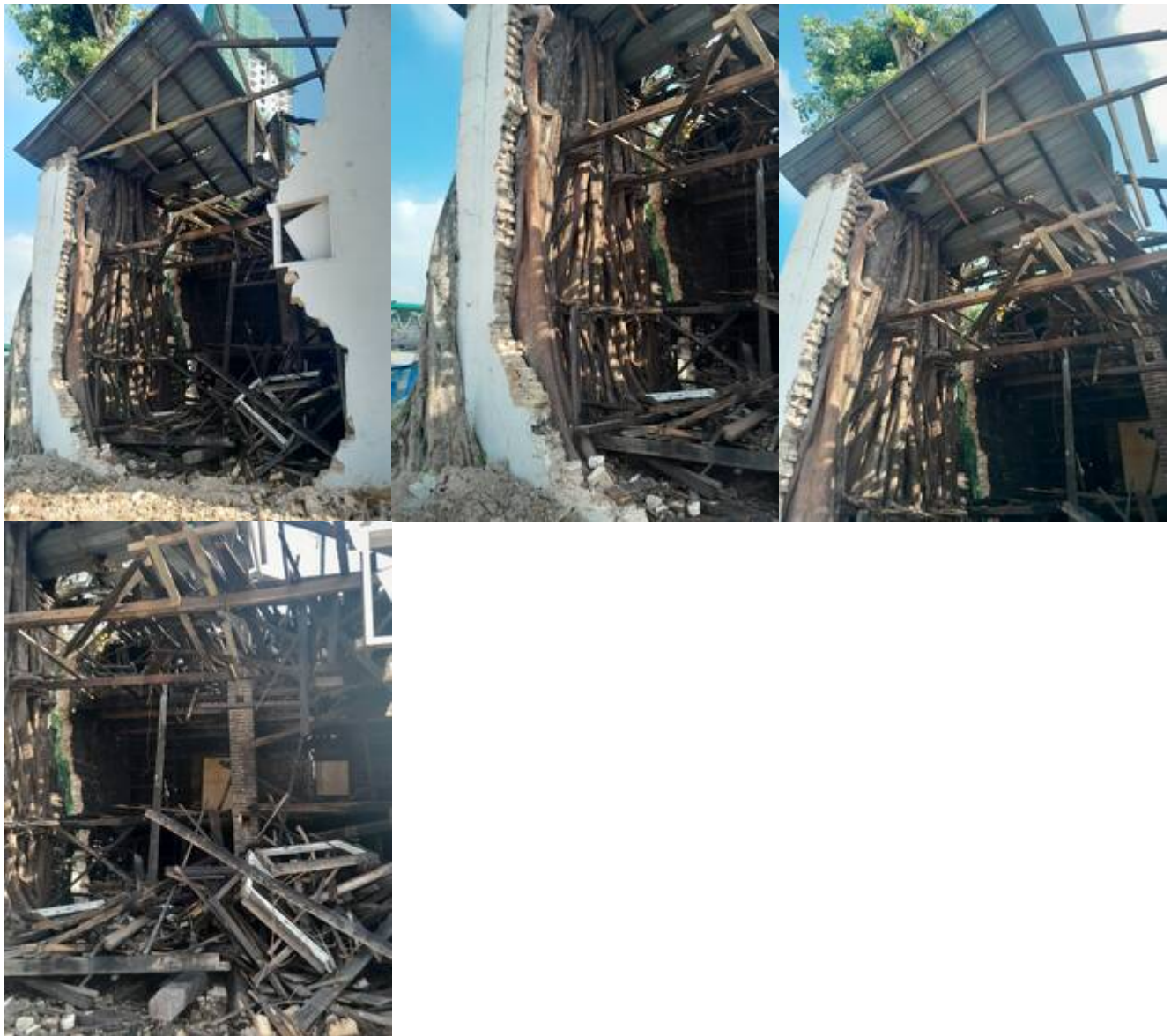
Gambar-gambar tahun 2023, diambil dari dinding sebelah selatan yang telah dirobohkan. Kelihatan pohon besar (beringin?) yang telah menjalar meliputi hampir keseluruhan dinding sebelah barat, termasuk bahagian dalamnya.
