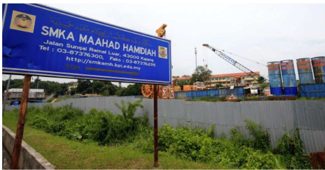
PEMBANGUNAN yang dijalankan berhampiran Sekolah Menengah Kebangsaan Agama (SMKA) Maahad Hamidiah, Kajang. - Foto Sairien Nafis
