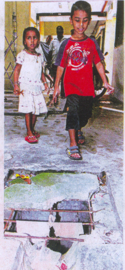
PENUTUP longkang di Apartmen Seri Pulai yang pecah ini mengundang risiko terutama kepada kanak-kanak.
